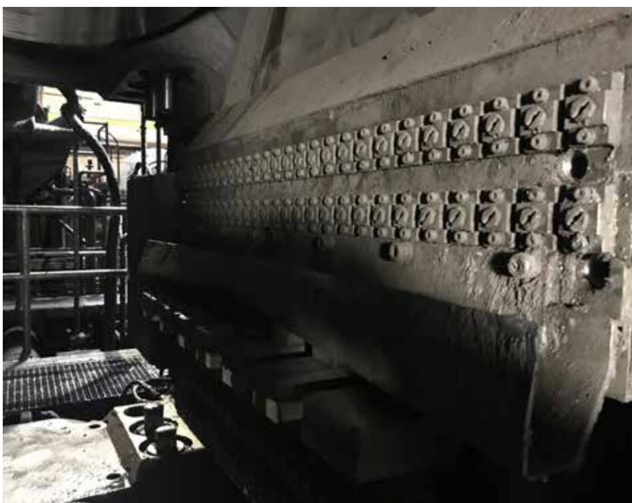
Obwohl sich im Kühlwasser enthaltener Eisenabrieb und Palmöl an der Sprüheinheit anlagern, arbeiten die Ventile zuverlässig (Foto: Evertz Hydrotechnik GmbH)
